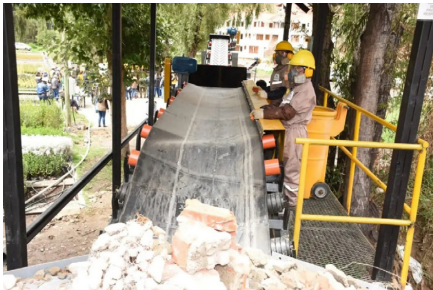
Figura 1. Planta piloto de transformación de residuos RCD,
