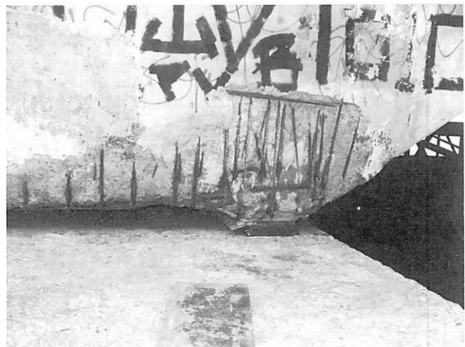
Fotografía N°1. Armadura expuesta presentando corrosión
