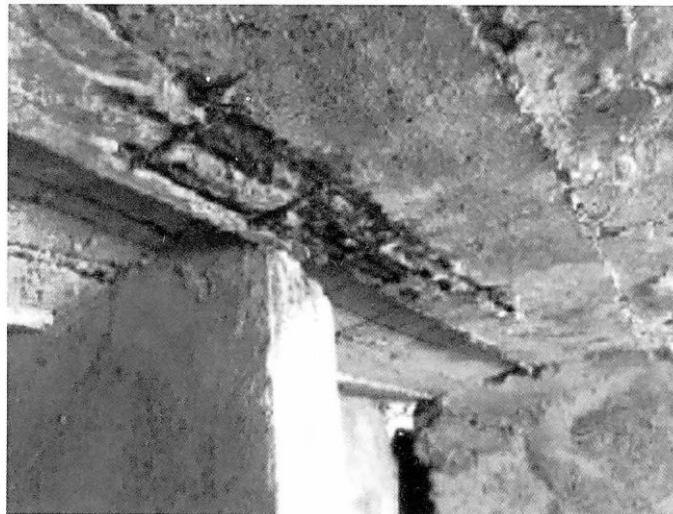
Fotografía i" 2. Ausencia de recubrimiento en armadura expuesta presentando corrosión
