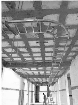
Figura N° 4. Componentes de la escalerilla
