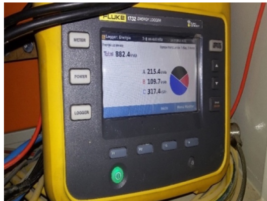
Figura 4. Analizador de red FLUKE. Fuente: Elaboración propia, 2019
