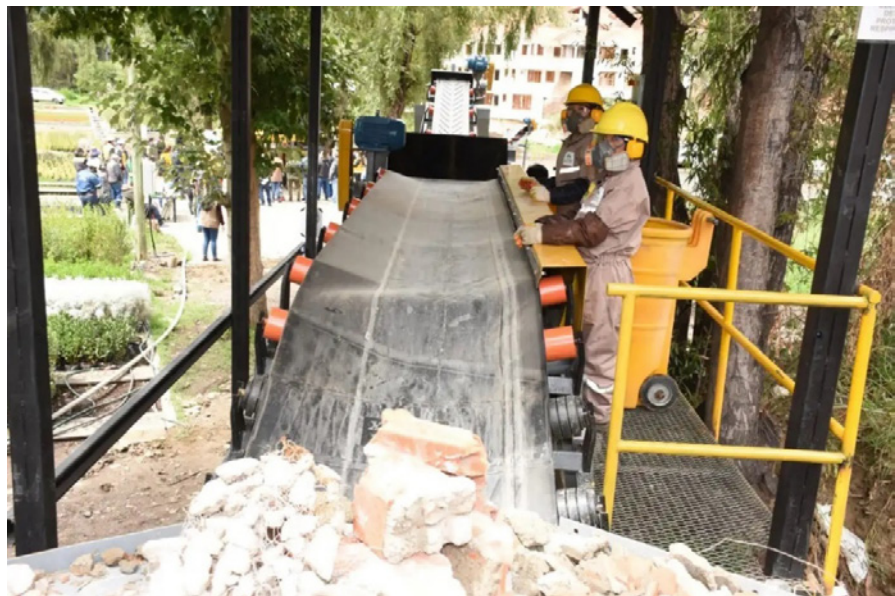
Figura 1. Planta piloto de transformación de residuos RCD,
